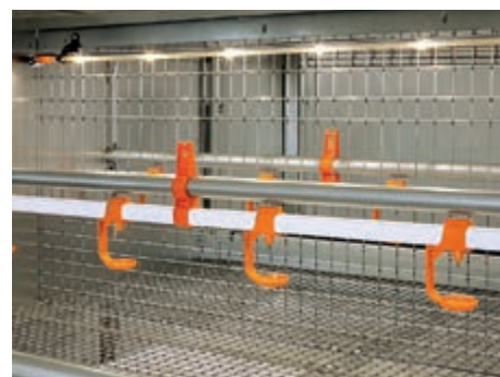
Die Wasseraufnahme ist nur von der Zwischenebene aus möglich
